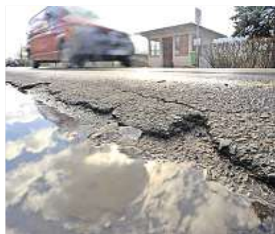
Die Straße hat laut dem Straßenbauamt durch den Winter weiter gelitten.
